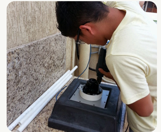
Detalle de canalización y conduit
