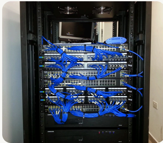
Rack de cableado estructurado
