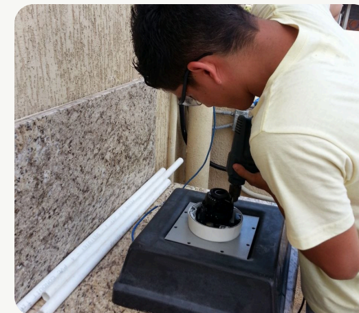
Detalle de canalización y conduit
